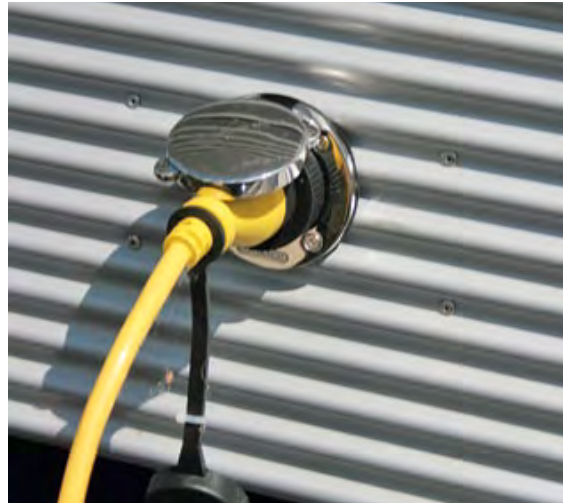
Landstromanschluss am Hausboot.
